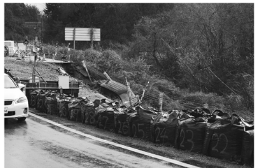
道路の一部が崩落したままの「のと里山海道」。本格復旧工事が続く＝昨年12月27日、石川県七尾市
